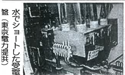
水でショートした受電盤(東京電力提供)
